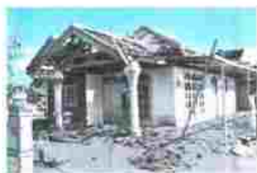
Gambar 7. Kerusakan Rumah Permanen
